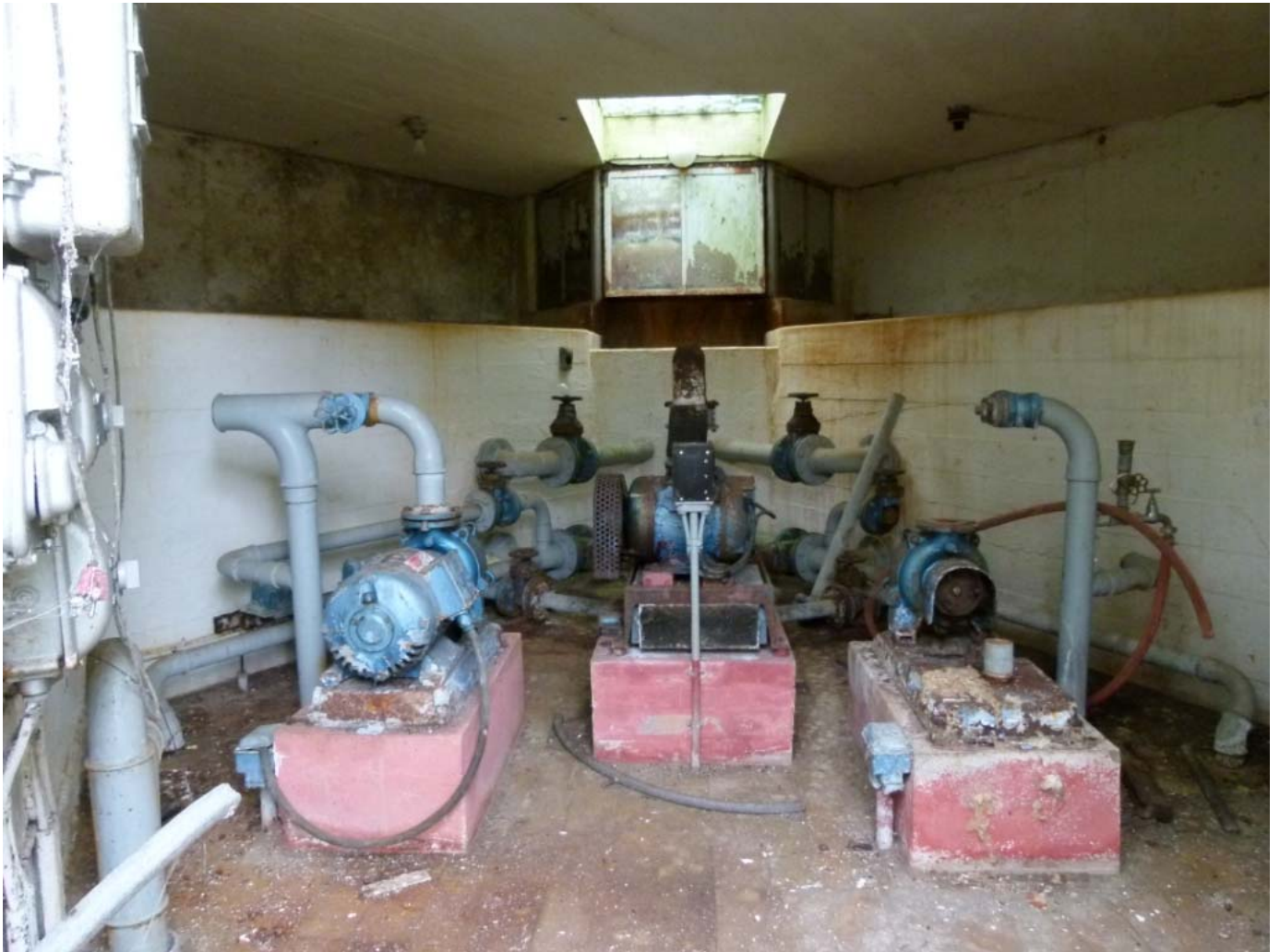
Inde i Svaneke Vandværk & Pumpestation Foto arkitekt Niels-Holger Larsen
